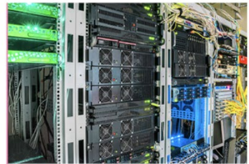
FIG. 6 Les ventilateurs d'une armoire de centre de données permettent la dissipation de la chaleur produite par effet Joule.
